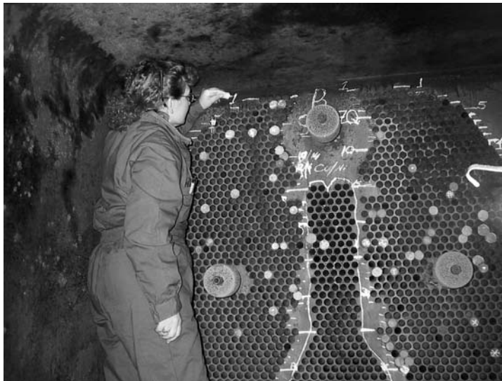
Inspección por corrientes inducidas de un intercambiador de calor de una central térmica. Identificación de la zona previo a los ensayos. Inspección en servicio.
